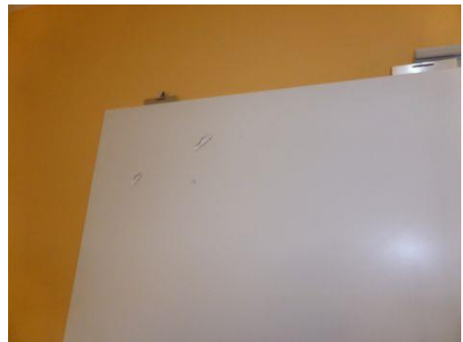
Porte abimée et décrochée du rail
