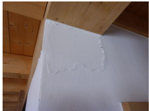
Fissure de tassement
