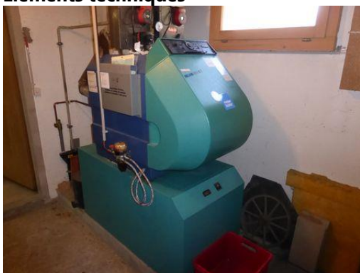
Chaudière à mazout | Boiler intégré (bac inférieur)
