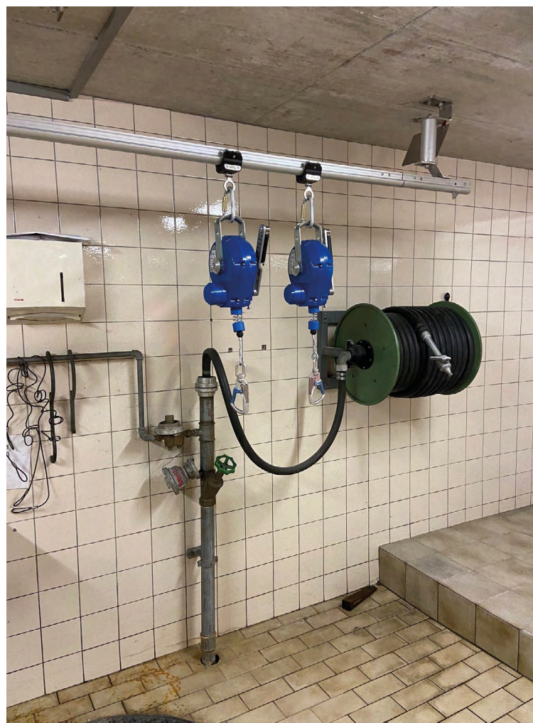
Rail fixe au plafond avec chariots mobiles équipés d'un système antichute combiné avec treuil de sauvetage (système permettant d'assurer la sécurité et le sauvetage sur de grandes surfaces) | Feste Schiene an der Decke mit mobilen Wagen, die mit einem Höhensicherungssystem mit Rettungshub ausgestattet sind (System zur Gewährleistung der Sicherheit und Rettung auf grossen Flächen)
