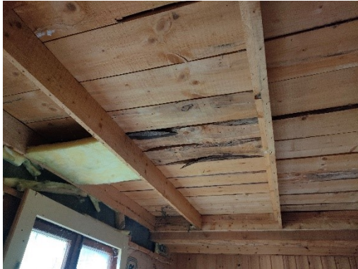
Plancher bois | Absence de finition
