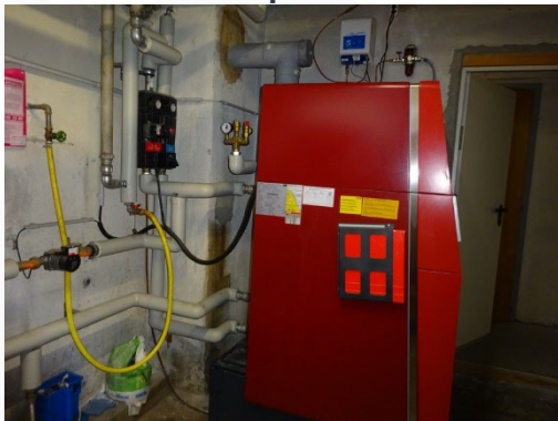
Chaudière à mazout
