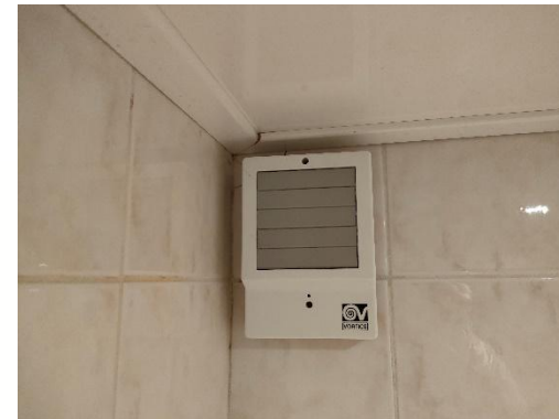
Ventilation mécanique | Douche
