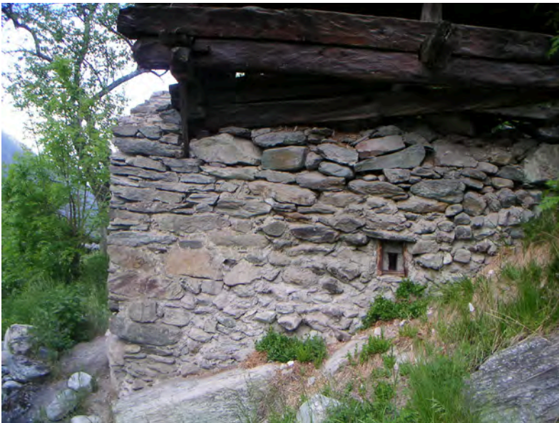
Fig. 6 Façade sud ; le couronnement de la maçonnerie a été perturbé lors de la pose du raccard, la petite fenêtre n'est pas d'origine.
