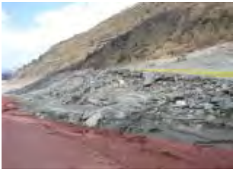
Fig. 42. Partie inondée du barrage, quelques dizaines de mètres en aval de la Cantine, vue vers le nord. L'ancien tracé soutenu par un petit muret d'accotement (en jaune) est visible en amont de la route du XIX e siècle (en rouge).
