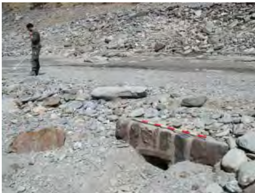
Fig.35. Restes d'un écoulement maçonné permettant le passage d'un ruisseau sous la route de 1893.
