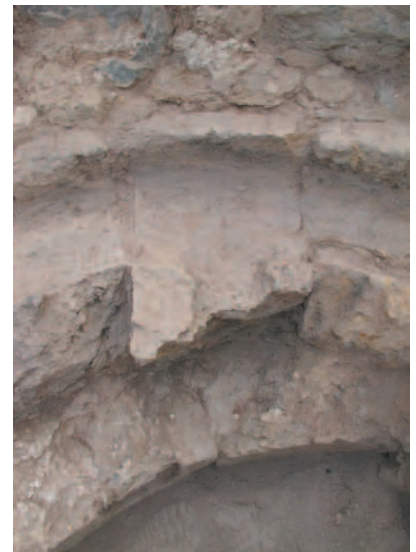
Fig. 16 Détail du déversoir du canal en pierres. D'autres déversoirs similaires pourraient exister sur le
