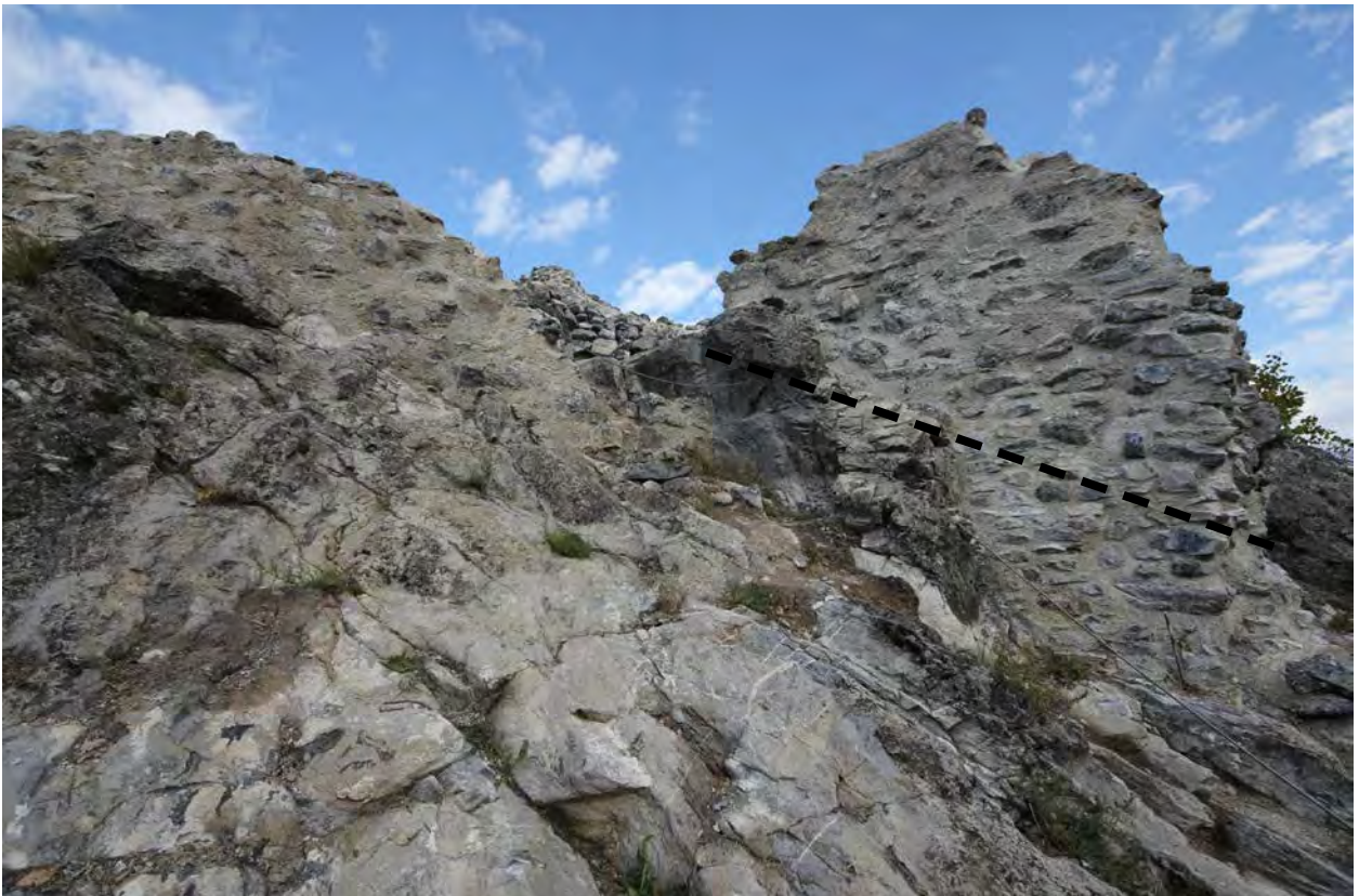
Fig. 3 Entaille oblique du rocher (inclinaison 47,5%) au sud de l'éperon (E) indiquant l'emplacement de la première volée d'escalier. Restitution d'un escalier de 13 marches de 0,25 m de hauteur et de 0,53 m de profondeur.
