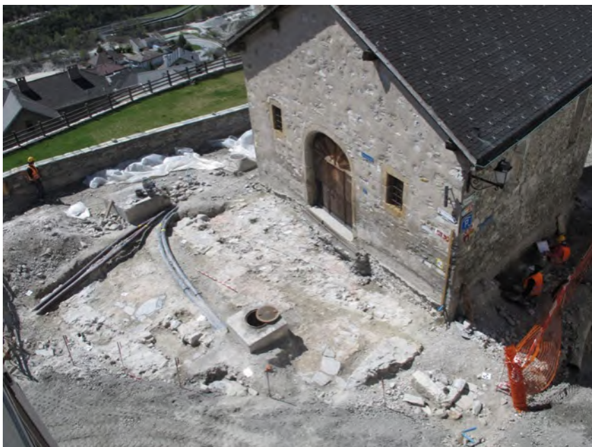
Fig. 11 – Leuk-Stadt, Rathausplatz. Eglise St. Peter. Choeur de l'église du bas Moyen Age, dégagé en 2018. Vue du nord-est.
