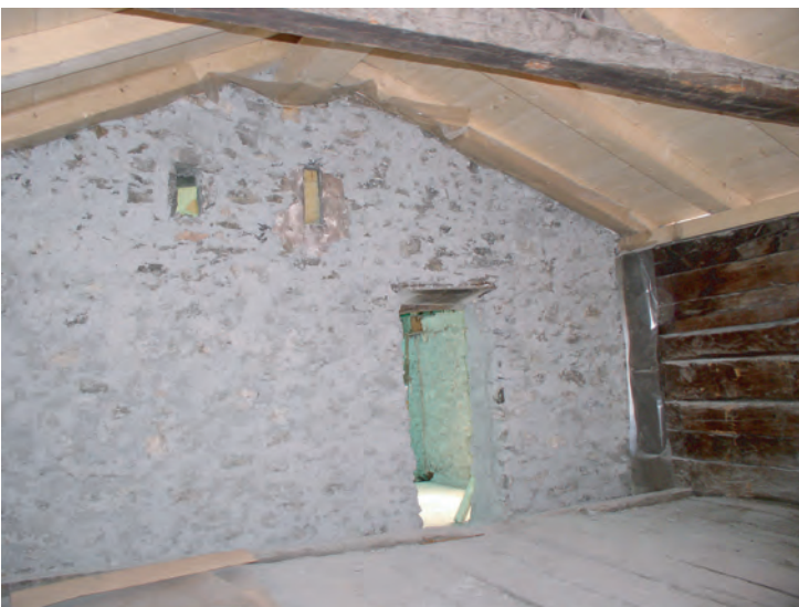
Fig. 35: Annexe Ouest, 2e étage (combles), paroi est. Les madriers des parois sud et nord viennent s'emboîter dans des poteaux verticaux, fixés contre l'ancien pignon.
