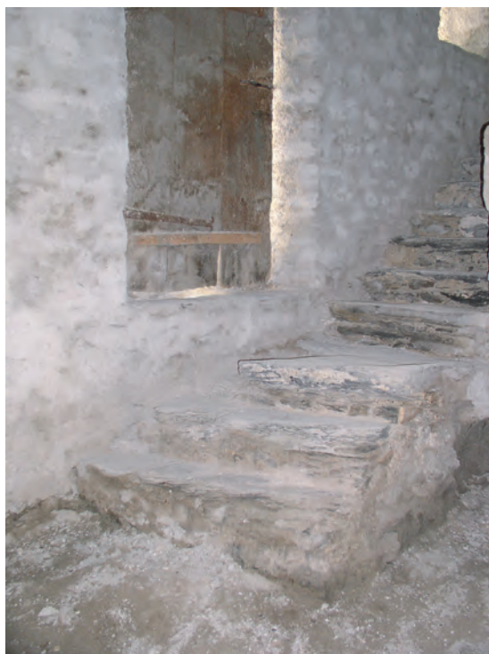
Fig. 15: Annexe Est, rez. Escalier maçonné, détail de la rallonge à la base. Vue sud-est.
