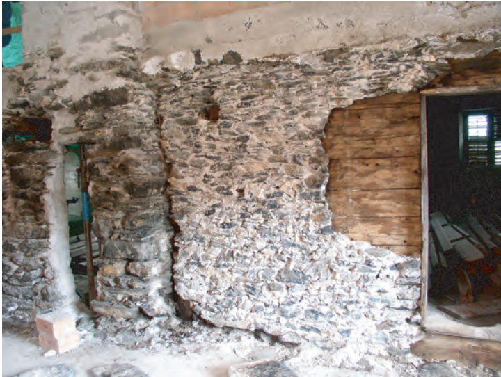
Fig. 30: Annexe Nord-Ouest. Maçonnerie de faible épaisseur (env. 20 cm) venant doubler le madrier de l'Annexe Ouest.
