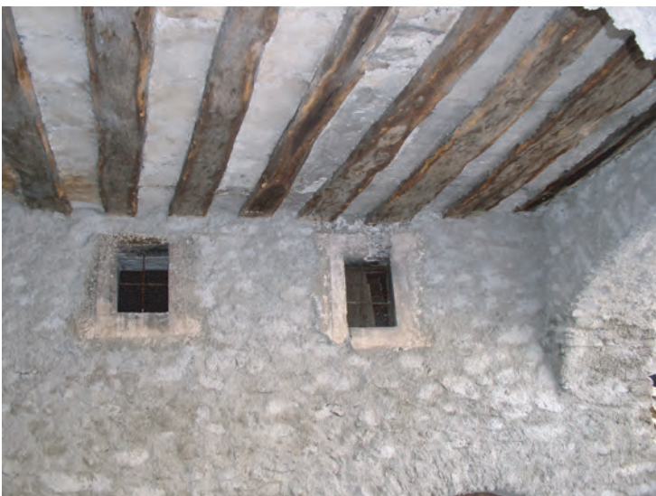
Fig. 22: Annexe Est, rez (Dépot). Plafond composé d'un solivage axé Nord-Sud avec entrevous maçonnés. Vue sud.
