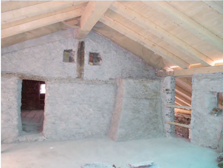
Fig. 33: Corps Principal, 2e étage (combles), paroi ouest. A gauche, la porte qui conduit à la chambre boisée de l'Annexe Ouest, à droite la conduite de cheminée du foyer situé un étage plus bas.
