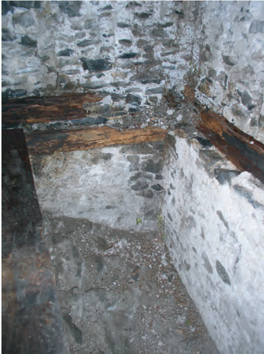
Fig. 17: Annexe Est, rez. Détail de la paroi crépie au-dessus de la voûte de la cave à vin. Dans les solives de rive, était encastrée la boiserie (ici démontée) qui a laissé son empreinte contre la maçonnerie. Vue de l'angle nord-est.
