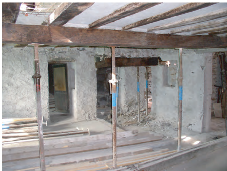
Fig. 23: Corps Principal, 1er étage. Au centre le foyer aménagé dans l'angle nord-ouest, à gauche la porte ouverte pour accéder à l'Annexe Ouest.
