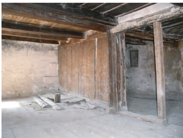
Fig. 11: Corps Principal, rez supérieur (Grange 1). La cloison composée d'une maçonnerie doublée de planches subdivisant la partie occidentale de la pièce. Vue ouest.
