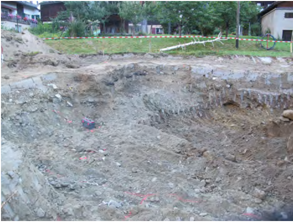
Fig.7 Randa, maison Biffiger. Vue nord-est. Excavation en cours pour la construction de la maison. Une série de fosses charbonneuses est visible dans le profil de l'excavation à l'arrière-plan.
