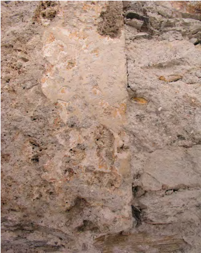
Abb.5 Kindergarten, Südfassade : Tuffsteinrahmen eines Kapellenfensters mit Resten der deckenden Verputzschicht.
