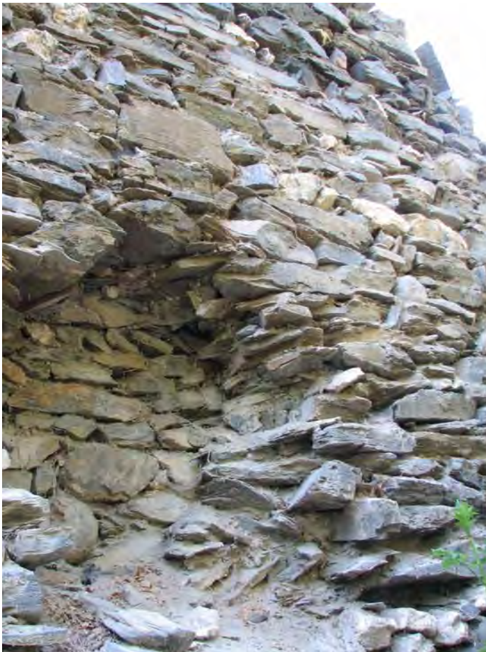
Fig. 16 Tronçon nord de l'enceinte avancée, face extérieure. Le doublage (UT9) s'est effondré, laissant apparaître le parement du mur antérieur (UT8).
