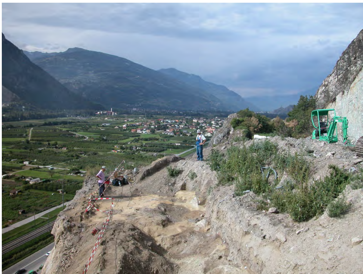
Figure 2. Vue de la partie ouest du plateau est (GP), à la limite du front de taille de la carrière : au premier plan, à gauche, la zone 1 dégagée à la pelle mécanique pour les travaux de stabilisation, après un premier nettoyage. On aperçoit dans les loess jaunes, les empreintes des structures en creux. Au centre, on distingue une partie de la coupe nord-ouest et, à droite, les secteurs encore protégés par le vignoble, sous les déblais de la zone 1. Au second plan, légèrement sur la droite, se trouve la petite colline qui ferme l'ensellement du plateau ouest (GQ) sur son flanc sud, et tout à droite, le flanc sud de la partie sommitale de colline du Grand Pré.
