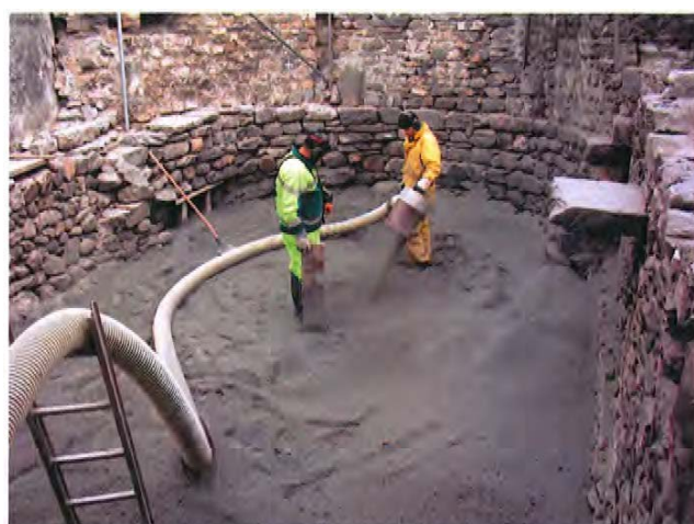
fig. 4 Remblayage des parties les plus profondes et fragiles du site par des sables et graviers.
