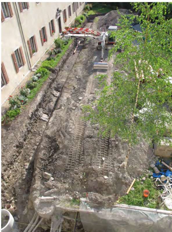
Fig. 4. St-Maurice, Jardin de l'Octogone. Tranchée 2, vue générale depuis le sud-ouest. Au pied de la façade du bâtiment conventuel.
