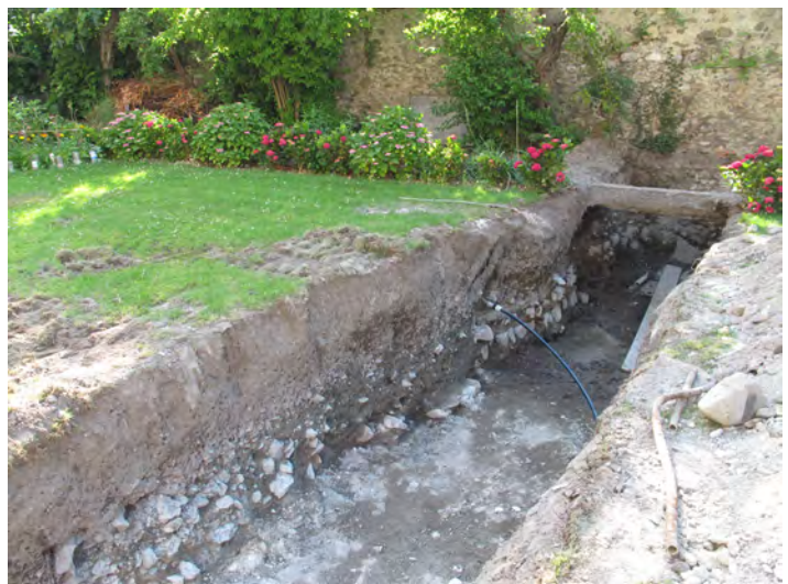
Fig. 5. St-Maurice, Jardin de l'Octogone. Tranchée 2, extrémité sud-est aboutissant au pied du mur de clôture. Vue générale du nord-ouest.
