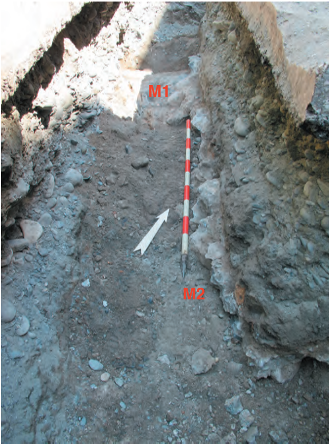
Fig. 3 Avenue d'Agaune. Tranchée vue vers le nord. A droite de la mire, le mur M2 dont le parement a été arraché lors du creusement de la tranchée.
