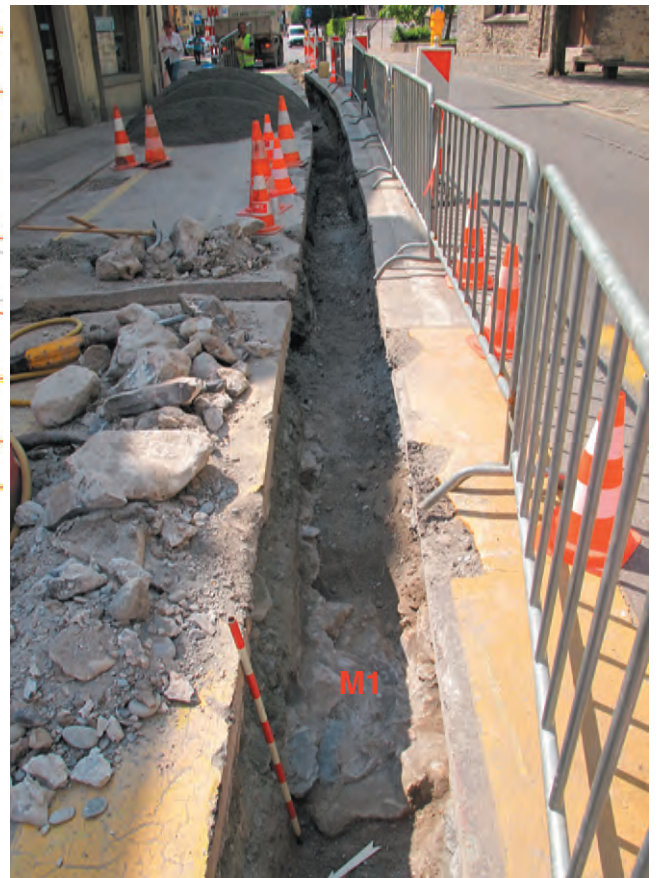
Fig. 2 Avenue d'Agaune. Tranchée vue vers le sud. Au premier plan le mur M1.
