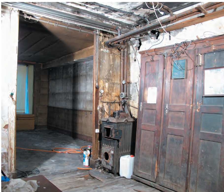
Fig. 17 Bâtiment n° 61, rez-de-chaussée, local 0.9. La cloison de refend qui délimite le dépôt.
