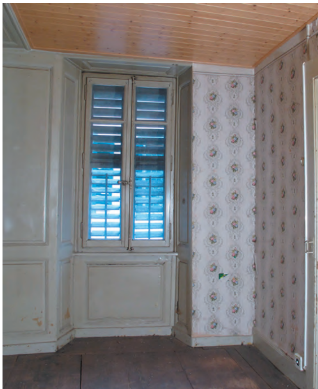
Fig. 30A Bâtiment n° 63/65, 1er étage, local 2.11N. Salle d'angle aux boiseries simples, avec le plancher en lames larges. A droite de la fenêtre, la boiserie est conservée derrière le revêtement en pavatex. Le plafond contemporain n'existe cependant plus sous le lambris récent (cf. fig. 30B).
