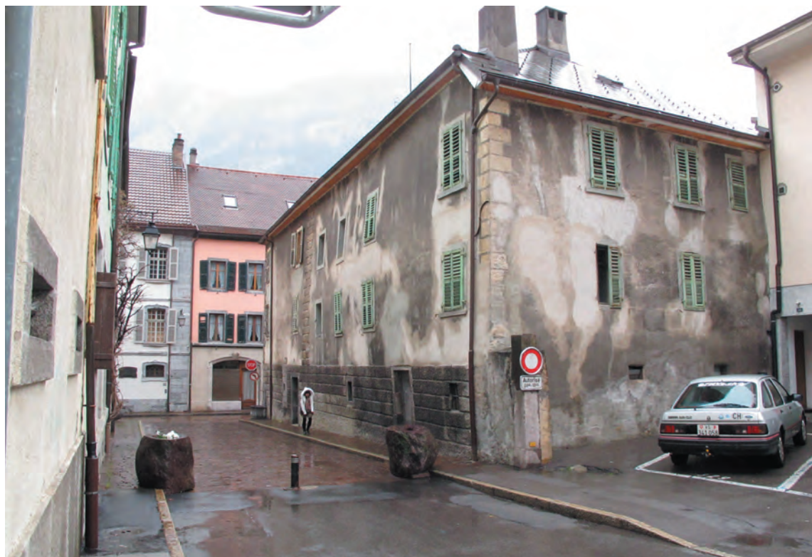
Fig. 8 Façade du bâtiment n° 65 côté rue des petites fontaines (ancienne rue de l'Abbaye).
