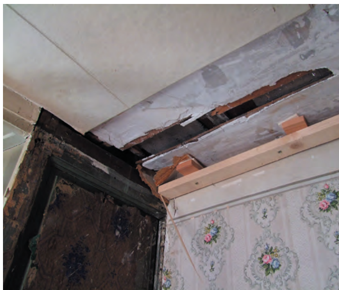
Fig. 30B Bâtiment n° 63/65, 1er étage, local 2.11N. Salle d'angle aux boiseries simples, sondage dans le plafond (angle sud-est). Sous le lambris récent est apparu un plafond en carreaux de pavatex collé sur une couche de plâtre. La hauteur du plafond ancien est indiquée par la limite de coloration gris-bleuté de la boiserie.
