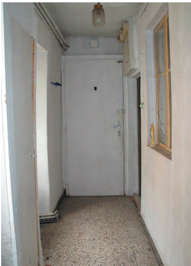
Fig. 31 Bâtiment n° 63/65, 1er étage, local 2.14. Vestige de l'ancienne galerie en façade nord, Vue vers l'est.
