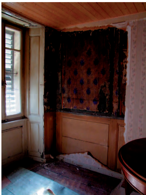
Fig. 30D Bâtiment n° 63/65, 1er étage, local 2.11S. Salle d'angle aux boiseries simples. L'ancienne boiserie est entièrement conservée. Elle a d'abord été transformée en lambris d'appuis de couleur blanc-crème avec tapisserie en papier, avant d'être recouverte par des panneaux de pavatex.
