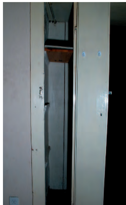
Fig. 27 B Bâtiment n° 63/65, local 1.12. Détail de l'armoire.
