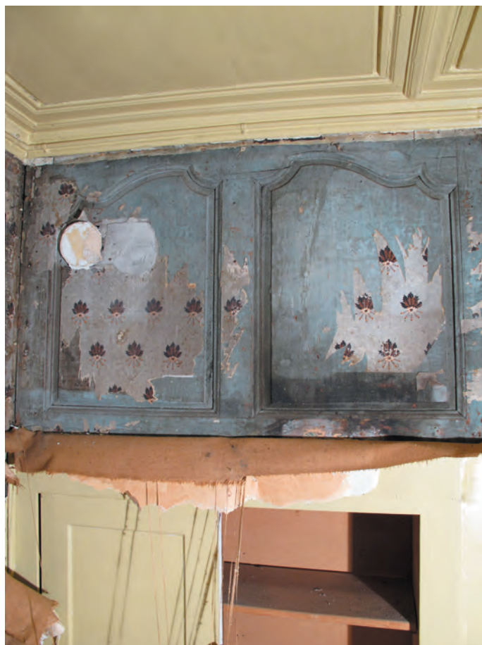
Fig. 28C Bâtiment n° 63/65, 1er étage, local 1.11S. Détail de la boiserie dans l'angle sud-ouest, au-dessus de l'emplacement de l'ancien poêle (remplacée par une armoire).
