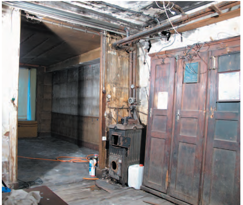
Fig. 17 Bâtiment n° 61, rez-de-chaussée, local 0.9. La cloison de refend qui délimite le dépôt.
