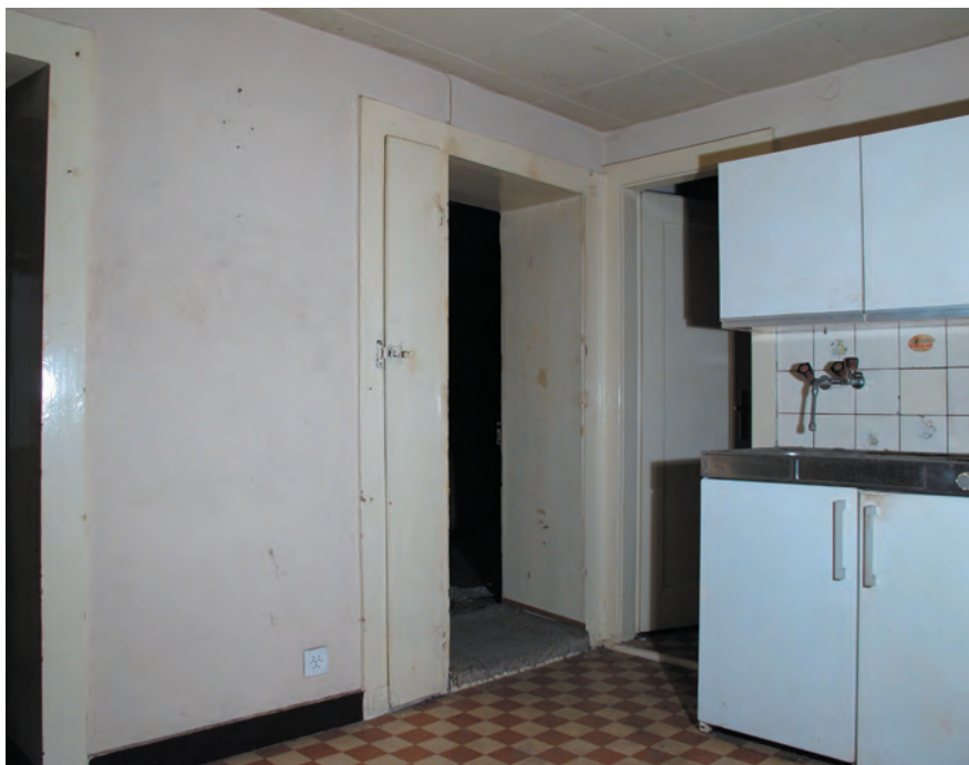
Fig. 27 A Bâtiment n° 63/65, 1er étage, local 1.12. Cuisine. A centre, l'ancienne porte donnant dans la pièce boisée. L'ouverture de la porte a été réduite probablement lors de la subdivision de la pièce en insérant une armoire étroite. Vue vers le sud-est.
