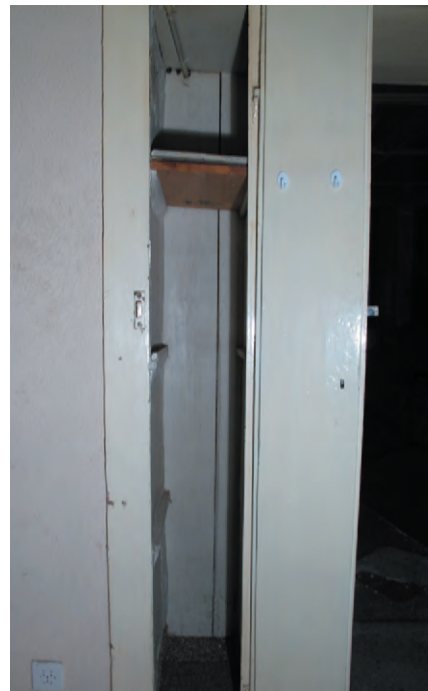
Fig. 27 B Bâtiment n° 63/65, local 1.12. Détail de l'armoire.
