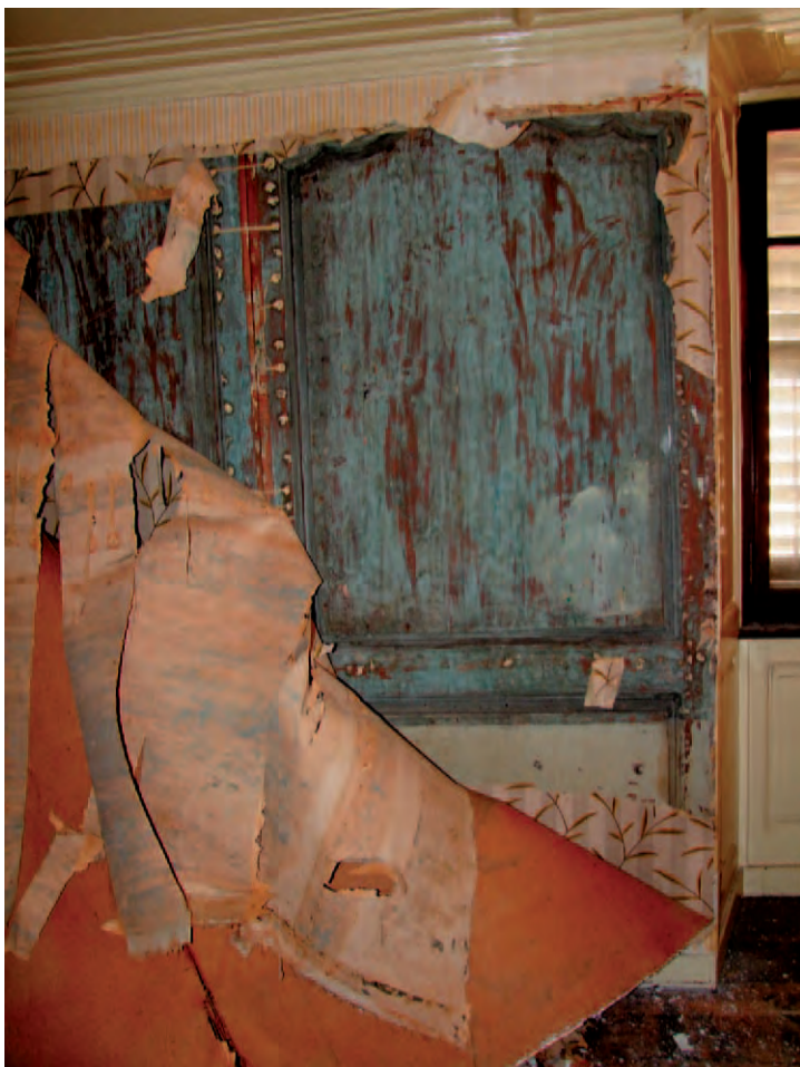
Fig. 28D Bâtiment n° 63/65, 1er étage, local 1.11N. Détail de la boiserie de la paroi nord. L'ancienne boiserie est entièrement conservée. Elle a d'abord été transformée en lambris d'appuis de couleur blanc-crème avant d'être recouverte par une toile de tapisserie (deux couches).
