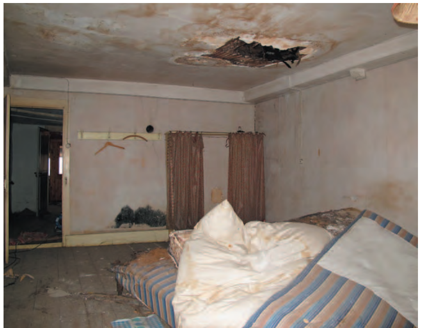
Fig. 15 Bâtiment n° 59, 2e étage, local 2.1. Le solivage du plafond est posé latéralement sur une poutre de rive tenue par des consoles.
