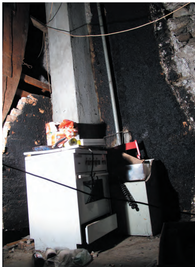
Fig. 32 Bâtiment n° 63/65, combles, local 3.3. Vestige de l'ancienne hotte de cheminée, Vue vers le sud-est.
