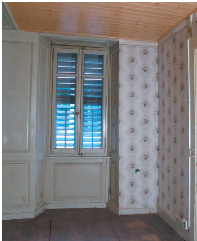
Fig. 30A Bâtiment n° 63/65, 1er étage, local 2.11N. Salle d'angle aux boiseries simples, avec le plancher en lames larges. A droite de la fenêtre, la boiserie est conservée derrière le revêtement en pavatex. Le plafond contemporain n'existe cependant plus sous le lambris récent (cf. fig. 30B).
