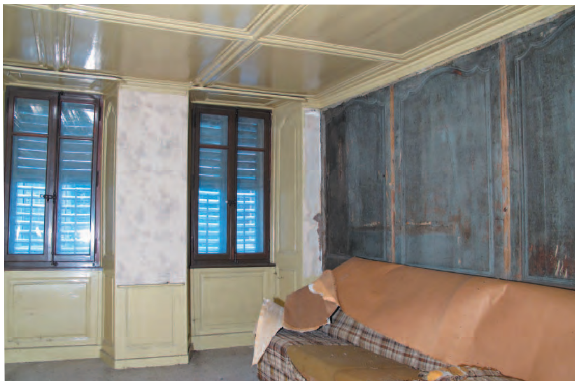
Fig. 28A Bâtiment n° 63/65, 1er étage, local 1.11S. Salle d'angle boisée, sous la moquette est conservé le plancher en lames larges. Vue vers le sud-est.
