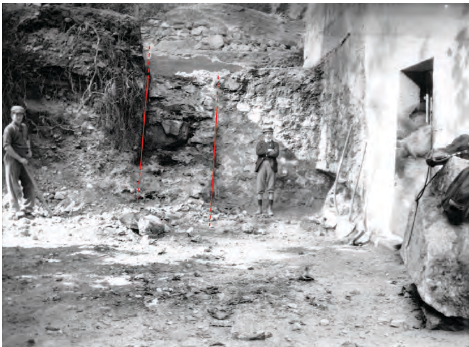
Fig.3. Démolition des latrines pour la construction du château d'eau en 1906. En rouge : les parements d'un éventuel contrefort arraché, renforçant la façade sud du chevet occidental de l'église bleu clair. Vue vers le nord.
