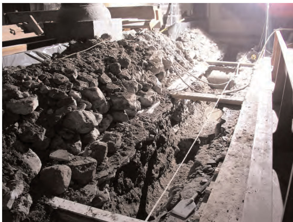
Fig. 16 Basilique actuelle. Tranchée ouverte pour le remplacement de la canalisation évacuant l'eau de la source à travers le couloir des catacombes. Vue vers l'est.
