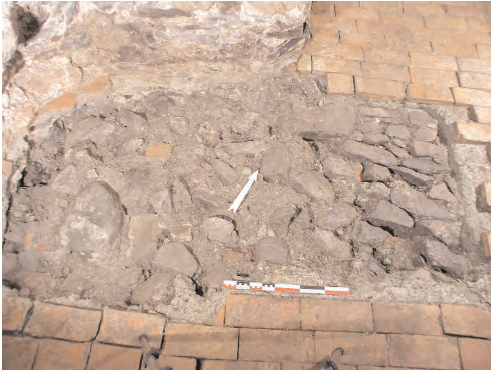
Fig. 9 Cave 3. Sondage à l'emplacement d'une perturbation du pavage. Détail du radier s'enfilant sous le sol en briques. Vue vers le nord.
