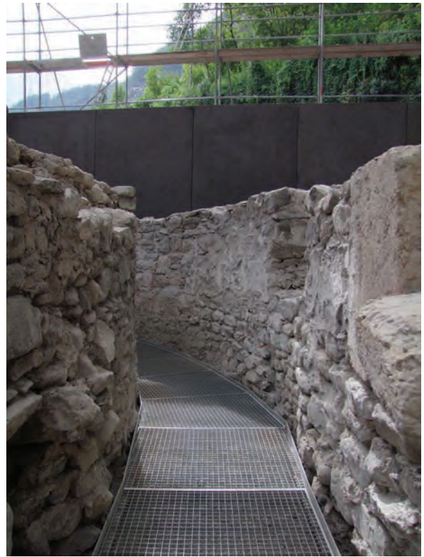
Fig. 8/18. Martolet. Crypte à oculus dentale, partie nord du oculus semi-circulaire. Vue vers le sud-ouest.
