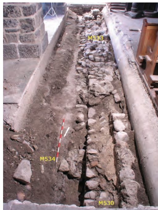
Fig. 1/28. Basilique actuelle, tranchée de canalisation. 2004 Le mur occidental de l'église du Parvis a été mis au jour.
