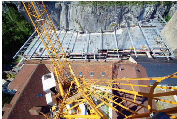
Fig. 1/42. Cour du Martolet, construction de la nouvelle toiture dans la paroi rocheuse. (image prise par l'entreprise de construction, 2007-2008)
