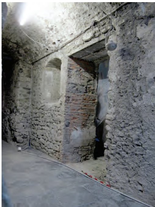
Fig. 1/38. Aile nord du bâtiment conventuel (couloir des catacombes), réouverture d'une ancienne porte latérale. 2014
