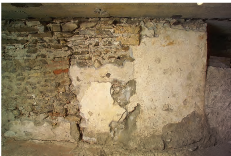
Fig. 6/7. Martolet. Rampe d'accès, paroi nord, prolongement pour la troisième église. Vue vers le nord-ouest, 2004.
