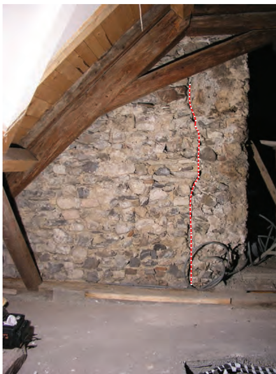
Fig. 9/21. Chapelle Felix V. Mur délimitant les voûtes du côté ouest. Vue vers l'est. La fissure verticale correspond à la ligne d'arrabement de l'ancienne façade de la chapelle.
