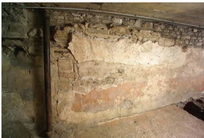
Fig. 5/23. Martolet. Couloir d'aè s de l'église rouge. Renforcement des maçonneries par un doublage s riant d'appui à une vûte (faç nord du ouloir). Tera 2003
