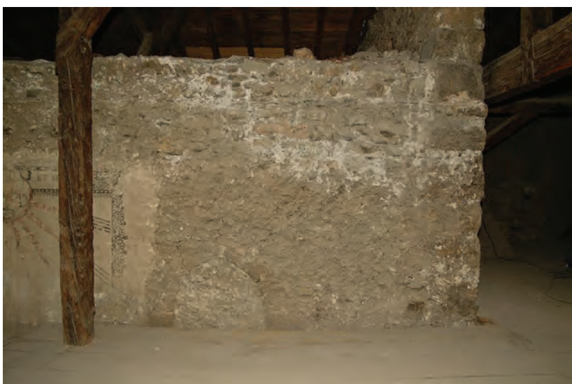
Fig. 9/18. Chapelle Felix V. Façade sud au niveau des combles du bâtiment abbatial. Angle sud-est.
