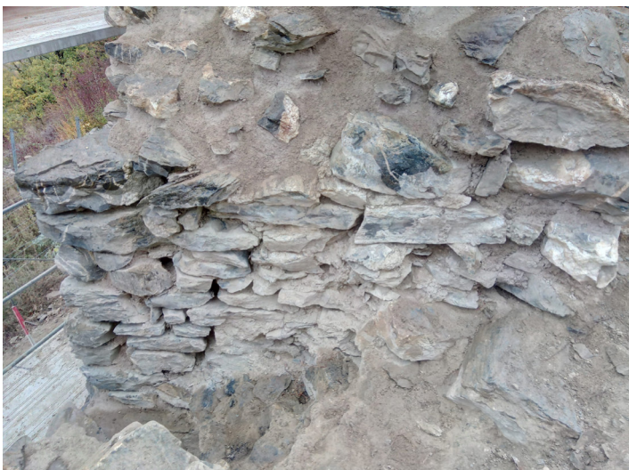
Fig. 25 – Côté sud-ouest de l'embrasure de l'archère Str107. La tablette est fortement érodée, mais la pente de celle-ci est bien visible. Elle pourrait même dessiner une sorte d'escalier.
