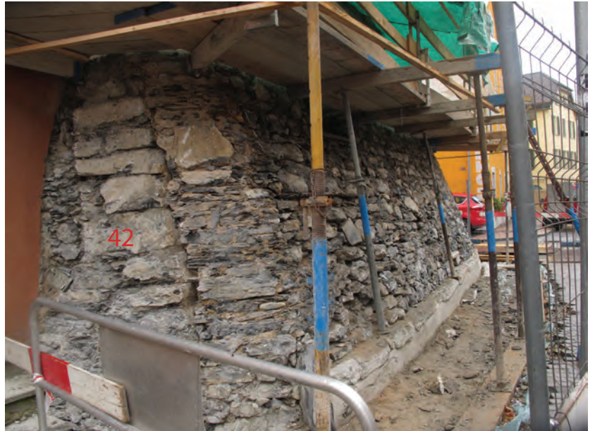
Fig. 10 Sierre, Château des vidomnes. Glacis de la façade nord, vue vers l'ouest. Le parement du glacis actuel double un contrefort plus ancien (1 er glacis) dont le chaînage d'angle est constitué de grandes pierres parfaitement appareillées (UT42).
