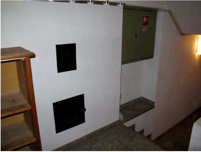
IMG_1032.JPG EG, Ofenfeuerung
