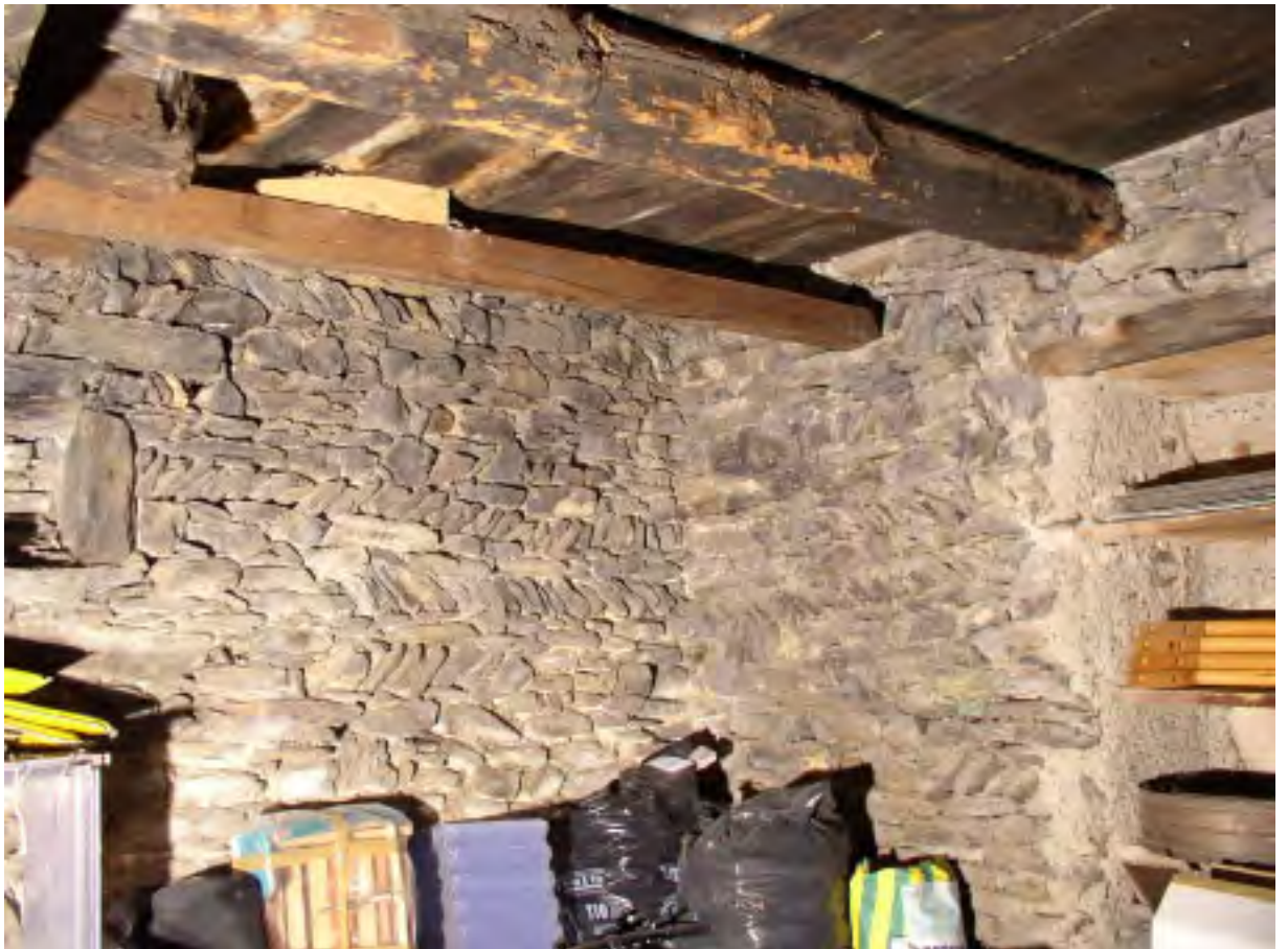
Fig. 4 Cave du soubassement (A), angle nord-est. La porte à droite perce la maçonnerie primitive, la niche à gauche est d'origine.
