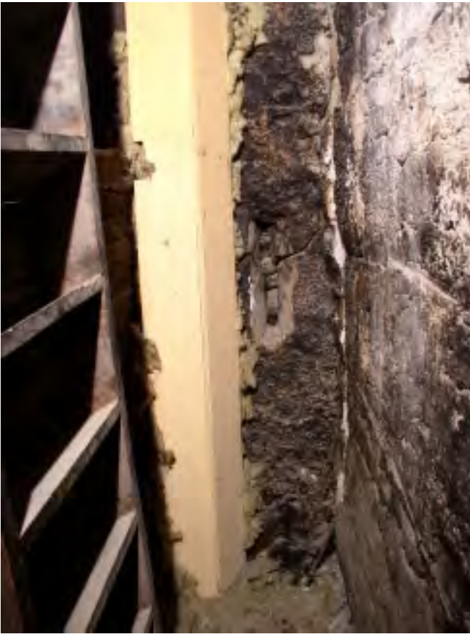
Fig. 15 Mur aligné sur la paroi occidentale du madrier (C), étage supérieur. Petite meurtrière bouchée plus tard par la maçonnerie contemporaine du madrier (F). La cloison du garde-manger (à droite) est construite entre coffrage et s'appuie contre le mur occidental. D'après la disposition générale des locaux, le garde-manger est plus récent que les chambres du madrier (C). A l'origine, la cuisine devait monter en un seul volume jusqu'au toit.
