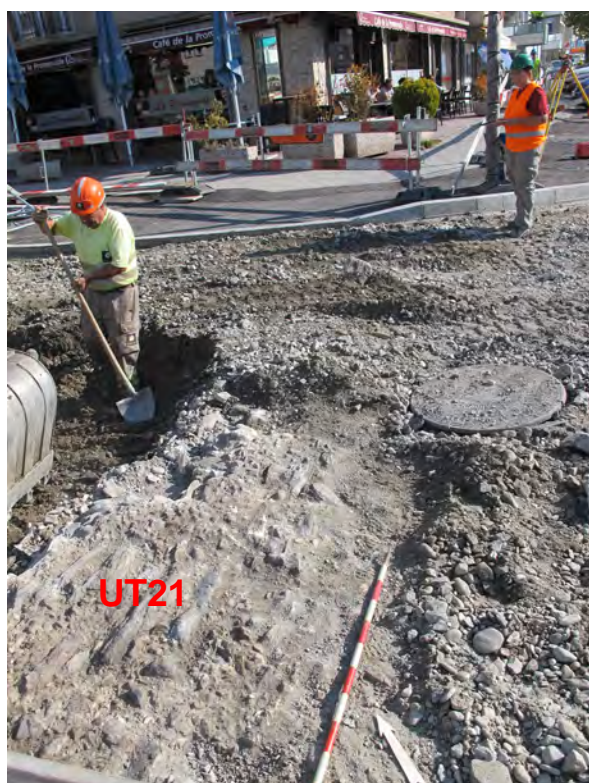
Fig. 26. Sion. Avenue Ritz. Restes du sol pavé de la fin du 19 e siècle ou du début du 20 e siècle. Ces pavés couvrent des conduites (désaffectées) en ciment.
