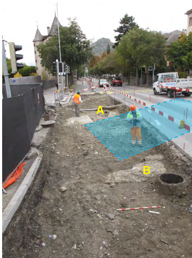
Fig. 12. Sion. Avenue Ritz. Etape du chantier au cours de laquelle les murs ouest et est de la «Porte de Savièse» ont été localisés, vue depuis l'est. En bleu: restitution de la surface intérieure du bâtiment. A et B : murs ouest et est de la «Porte de Savièse».
