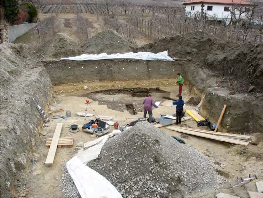
Vue générale du chantier de la Villa Chammartin en direction du Sud.
