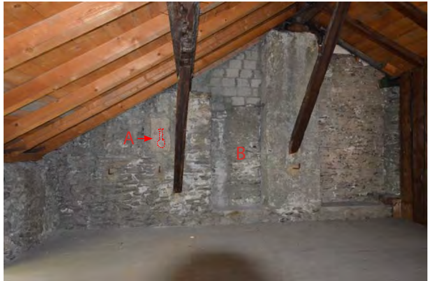
Fig. 40 Sion, Platea. Combles P5a, paroi sud. Plusieurs maçonneries différentes : certaines appartiennent au bâtiment M ou au bâtiment A attenants.
