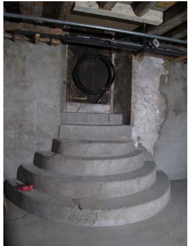
Fig. 27 Sion, Platea. Local P3a, paroi sud. L'écrépis de l'embrasure de la porte et des parois semble être le même qui comporte les négatifs de la voûte de la salle P3-4.
