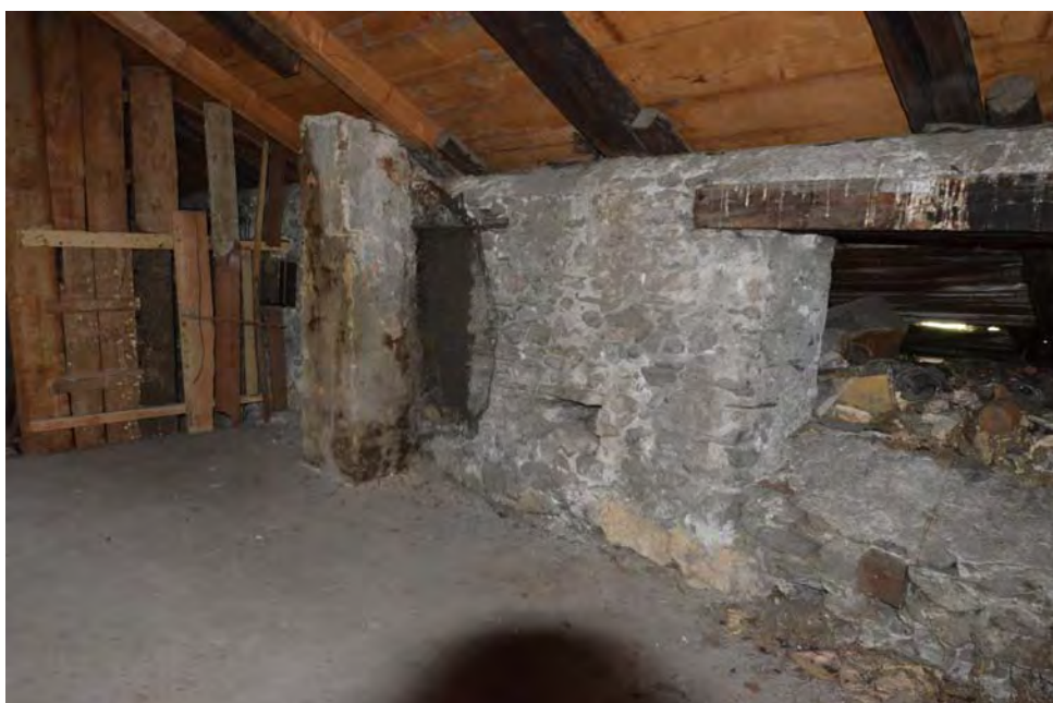
Fig. 36 Sion, Platea. Combles P5b, paroi ouest, vue vers le sud-ouest. Les ouvertures indiquent que l'annexe R (on en devine les combles) était à un moment donné plus bas que maintenant. Le conduit de cheminée provient d'un âtre ou poêle dont l'emplacement n'a pas encore été localisé (côté tour ou côté annexe ?).
