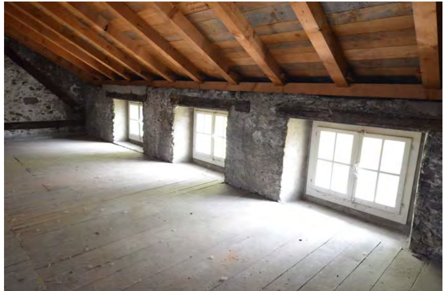
Fig. 37 Sion, Platea. Combles P5a, paroi est. Les fenêtres fonctionnent avec un niveau de sol qui se situe au-dessus de la voûte de la salle d'apparat.
