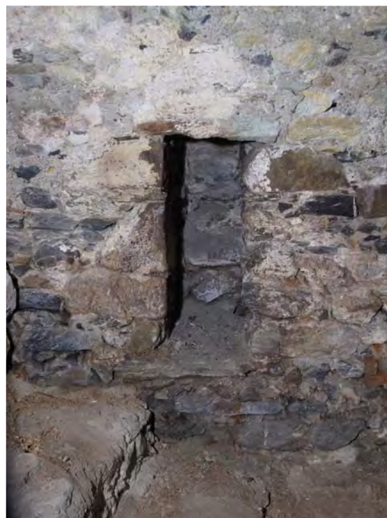
Fig. 6 Sion, Platea. Cave P1d, paroi nord. Extrémité inférieure du canal d'aération vertical.
