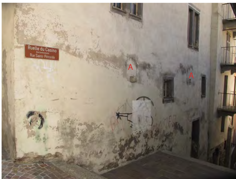
Fig.17 Sion, Platea. Façade nord, vue vers le sud-ouest. Les deux petites ouvertures carrées (A) correspondent au débouché supérieur des deux cheminées d'aération de la cave P1. Ces orifices étaient à l'origine plus grands (env. 40 cm de hauteur) et couverts d'un linteau arqué. Ils étaient encore ouverts en 1938 (cf. photo d'archives).
