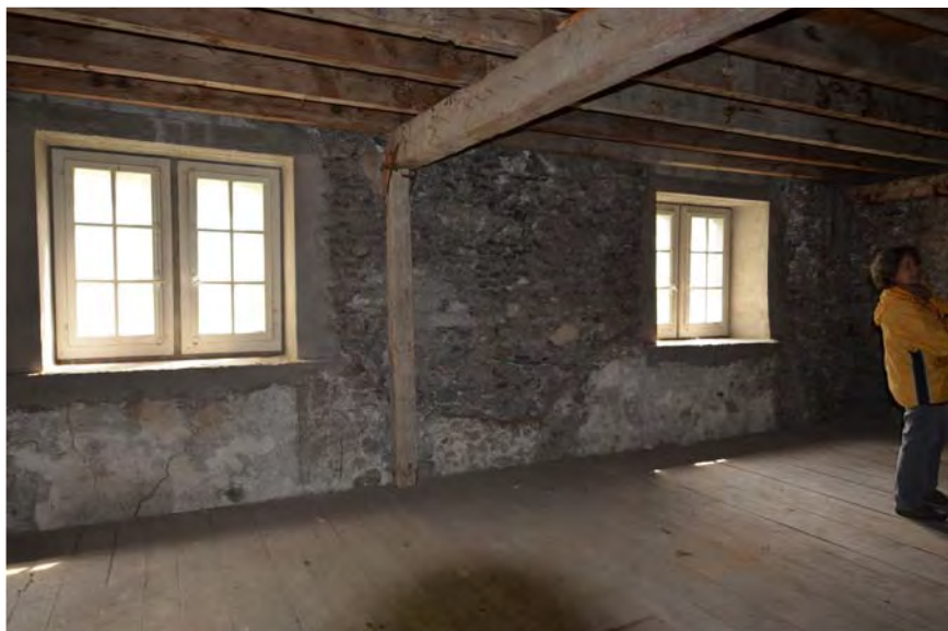
Fig. 32 Sion, Platea. Local P4a, paroi est. Les fenêtres correspondent au plancher actuel et non pas aux voûtains dont le contour est visible au pied de la paroi. Elles ont été percées au moment de la construction du plancher actuel.
