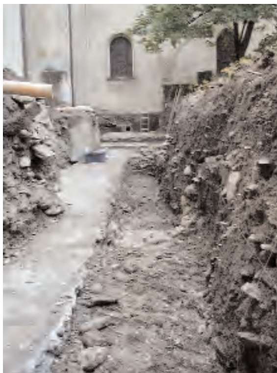
Fig.3 Sion, tranchée au nord de la Cathédrale. Vue générale des travaux (vue vers l'ouest); on distingue vers le milieu de la tranchée le mur M1 et vers la caisse à outils le mur M2
