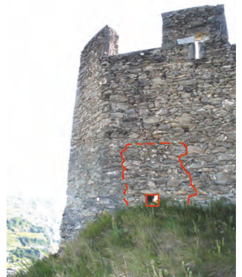
Fig. 10 Fortifications occidentales : Extrémité nord de la muraille, face extérieure. Tracé rouge : important bouchon avec trou (d'écoulement ?) à la base.
