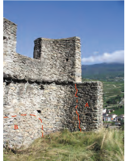
Fig. 13 Fortifications occidentales : Extrémité nord de la muraille, face intérieure. A : piédroit monté après arrachement du mur primitif. Celui-ci devait se poursuivre le long de la corniche rocheuse. B : important bouchon.
