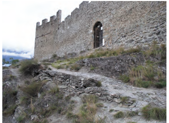
Fig. 31 Tronçon supérieur du chemin (fig. 25,G). Le muret de soutènement n'a pas été consolidé en 2005.
