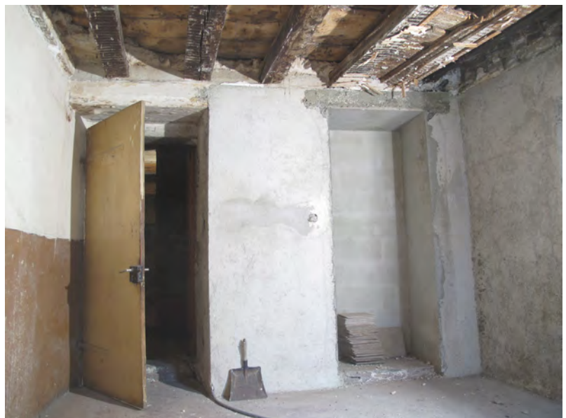
Fig. 50. Sion, Gd-Pont 8. 1 er étage, local 5 (chambre orientale). Paroi nord. La porte à droite donne sur la cage d'escalier. Transformée en armoire, elle a été remplacé par la porte à gauche.
