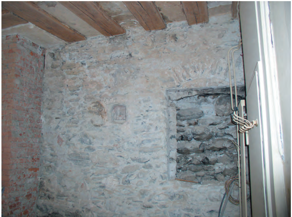
Fig. 15. 1 er étage, cuisine, fenêtre bouchée du mur est : l'arc de la fenêtre au-dessus du linteau est pris d'origine dans la maçonnerie ancienne. L'ouverture a été par la suite agrandie latéralement ensuite bouchée (2010).
