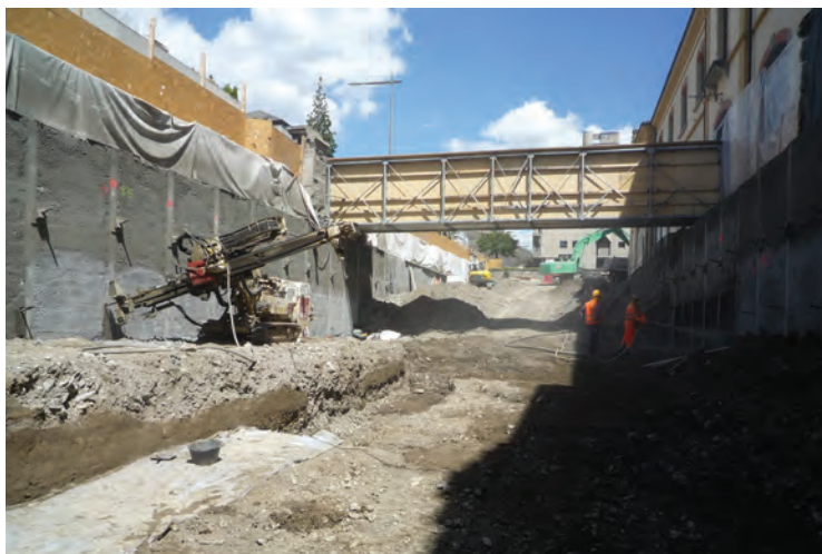
Fig. 6 — Les travaux d'excavation et l'arrivée sur les niveaux néolithiques à 5 m de profondeur. L'ancrage des parois de l'excavation s'enfonce jusqu'à 18 m au-delà des murs et sous les bâtiments aux alentours.
