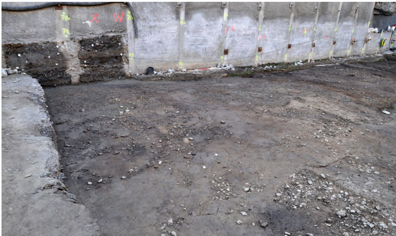
Fig. 19 — Environ 200 cibles (en jaune fluo) pour la photogrammétrie ont été implantées sur les quatre murs entourant le chantier.
