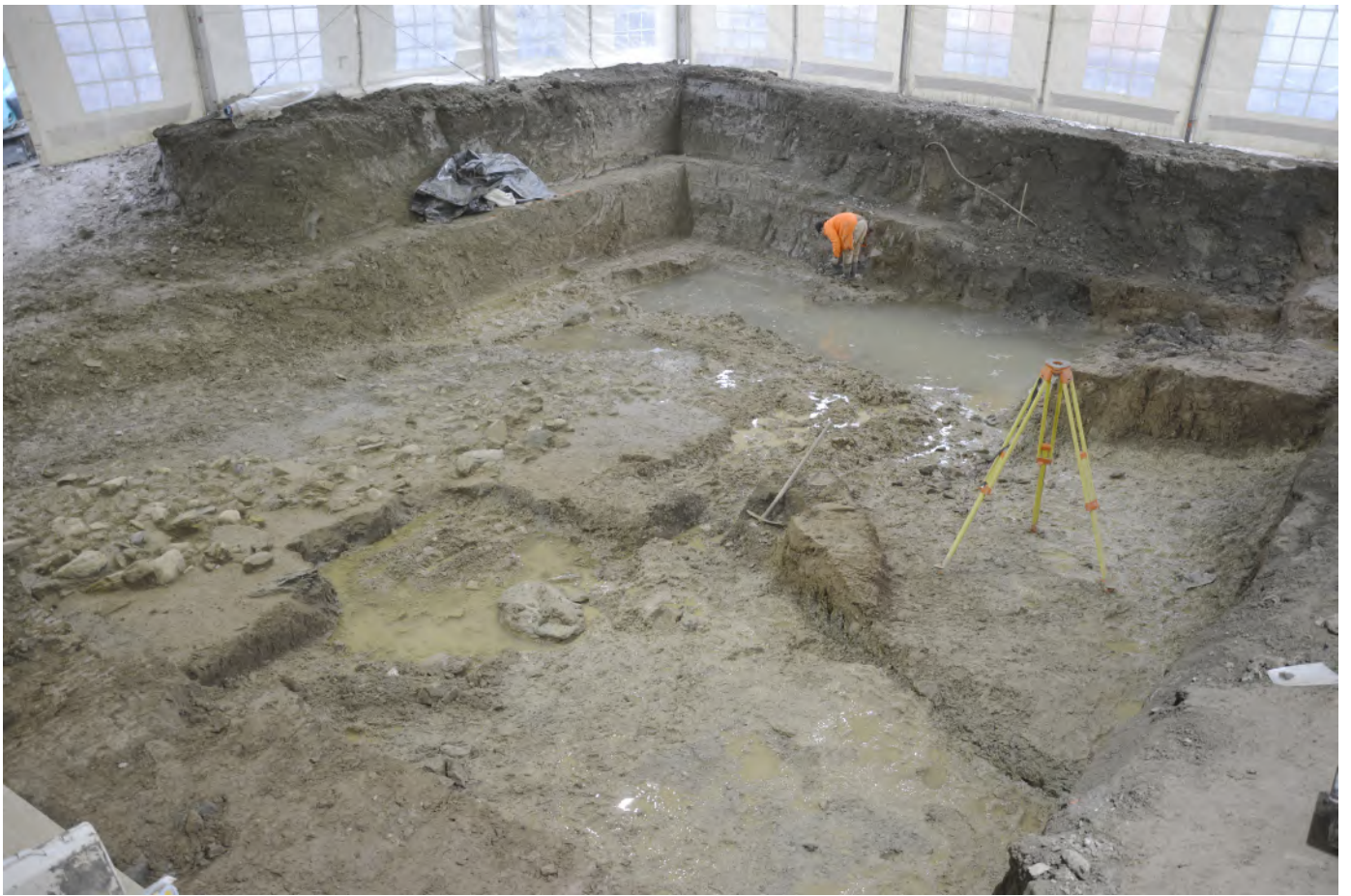
Fig. 7. Vue du fond de terrassement à la fin de la 1ère phase d'intervention.
